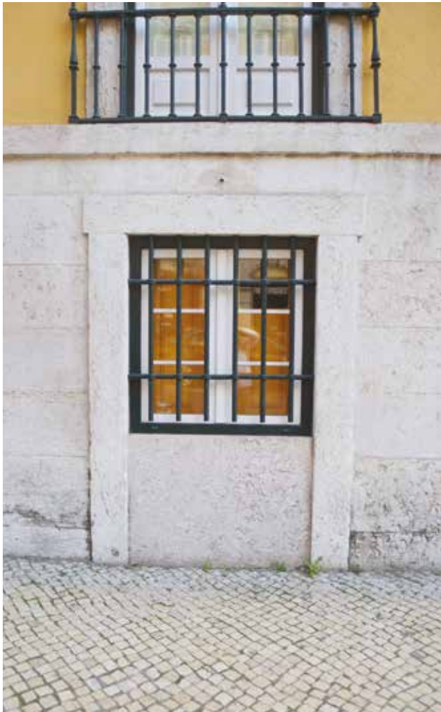
Fig. 5 - Portas e janelas ainda visíveis na fachada do Palácio, 2019.
